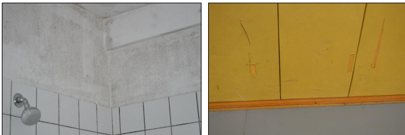
Abbildung 38: Sporthalle in Boren (links: Schimmelbefall in den Duschen; rechts: defekter Prallschutz)
