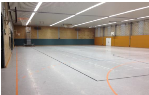
Foto: Der alte Hallenboden in der Turnhalle Tolk
